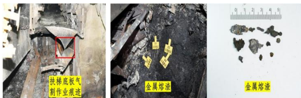
图 13 现场气割作业痕迹及下方库房金属熔渣
