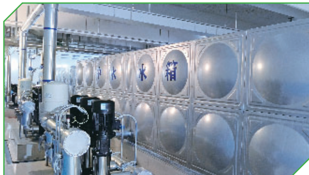
▲ 中央空调管网
